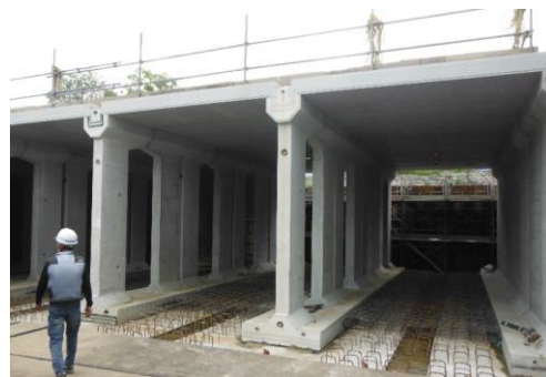
御幣島公園雨水貯留施設 (R6.6 運用予定)
