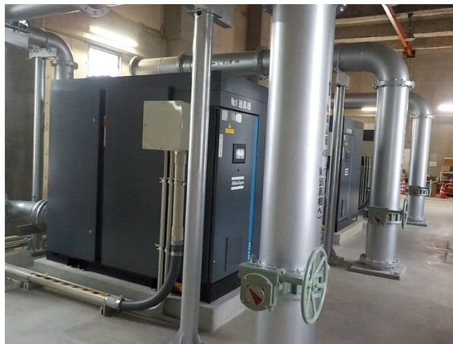
▲ 令和3年度導入 スクリュ式送風機（中央浄化センター）
