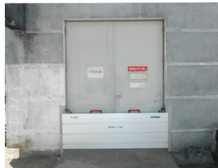
▲耐水化実施状況（止水板の設置） (中央浄化センター 汚水ポンプ棟)
