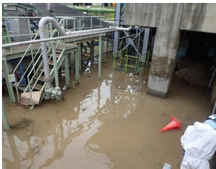
▲平成30年度 西日本豪雨被災状況 (中央浄化センター)
