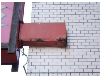
ブラケットカバーに発生したさびが進行した状態
