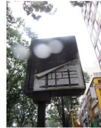
シート材がはがれかかった状態
