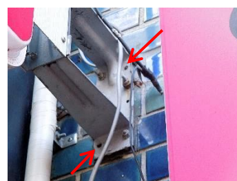
所定の場所にアンカーボルトがない状態
