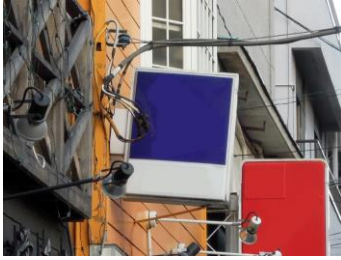
屋外広告物本体の傾き
