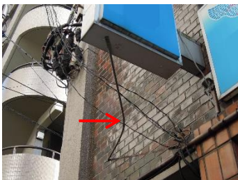
振れ止め棒が変形した状態
