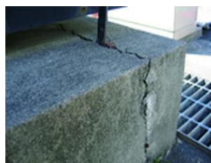
基礎にクラックが入った状態
