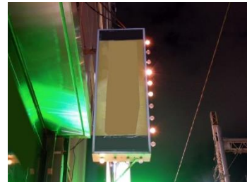
照明の不点灯
