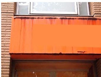
側板の腐食が進行した状態
