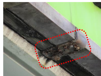
金具が劣化した状態
