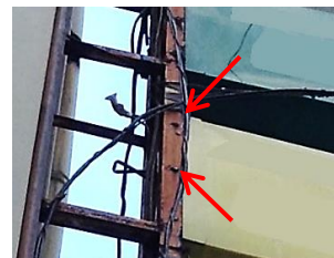
ボルトのゆるみや欠落した状態
