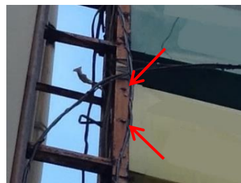
ボルトのゆるみや欠落した状態
