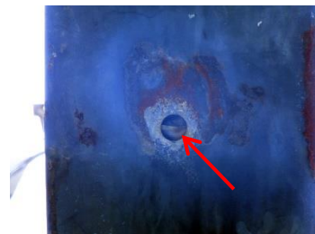
水抜き孔の詰まり
