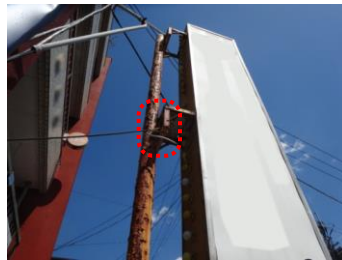
支柱・広告板接合部の腐食・隙間
