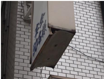
その他 (塗装剥離、腐食など)
