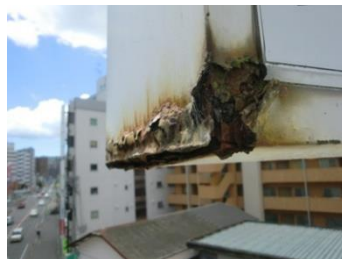
側板の腐食が進行した状態
