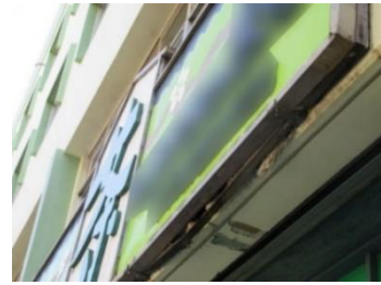
側板・表示面板押さえの腐食、破損・部材の欠落
