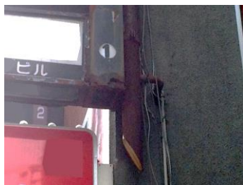
支持部が腐食した状態
