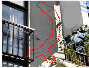
壁面にひびが生じた状態
