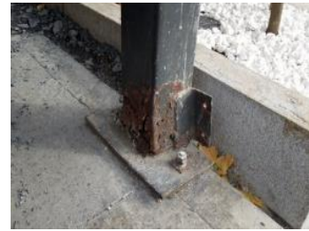
支柱根元の腐食が進行した状態
