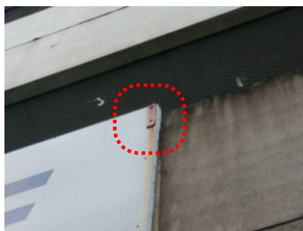
金具が劣化した状態
