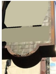
広告板底部の腐食、水抜き穴の詰まり
