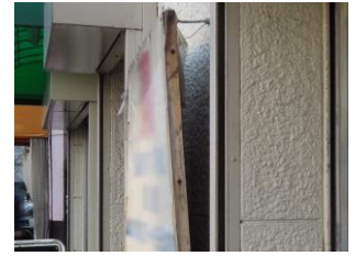
壁面との間に隙間が生じた状態
