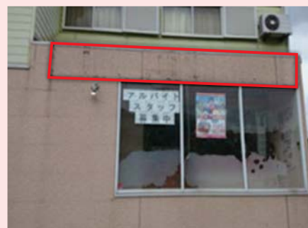
落下した後の壁面
