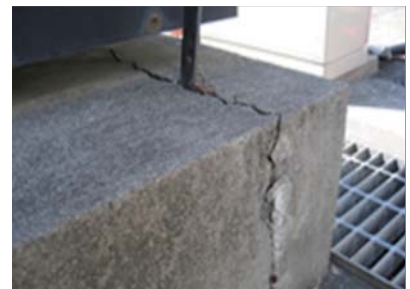
看板基礎のひび割れ
