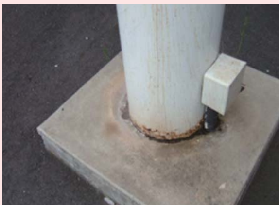
ポールの根元にサビが発生
