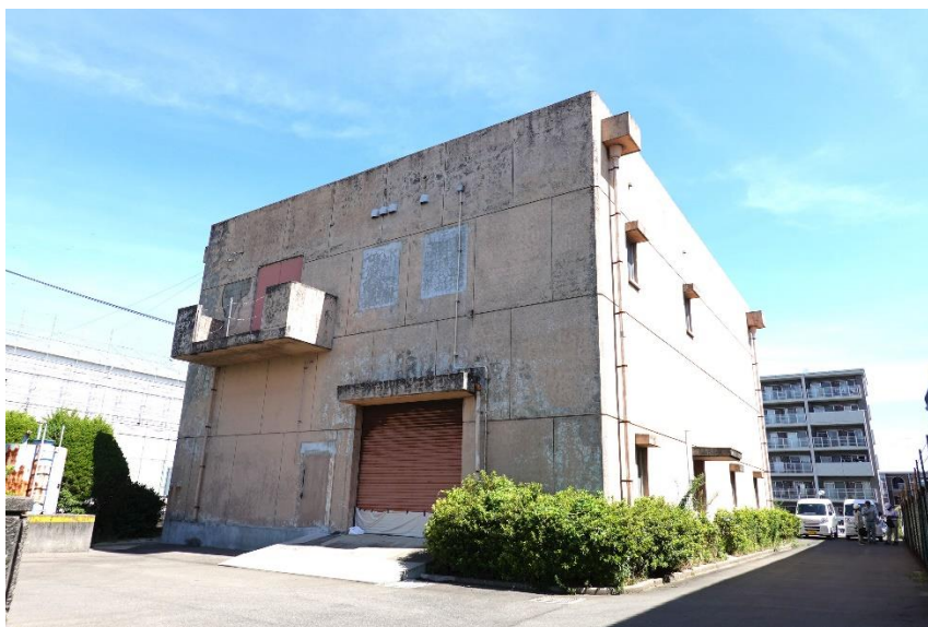
(櫛原中継ポンプ場)
