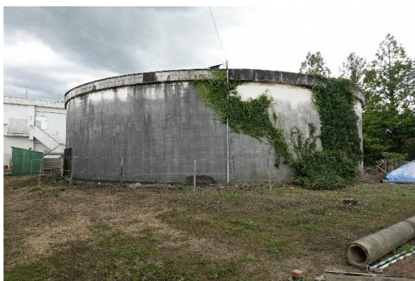
【建設物3】第1消化槽
