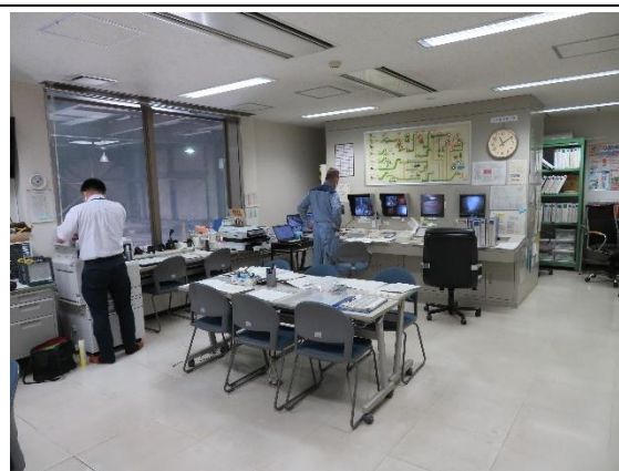
(リサイクルプラザ棟中央制御室)
