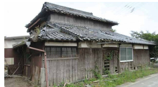
老朽化し倒壊の恐れがある空き家
