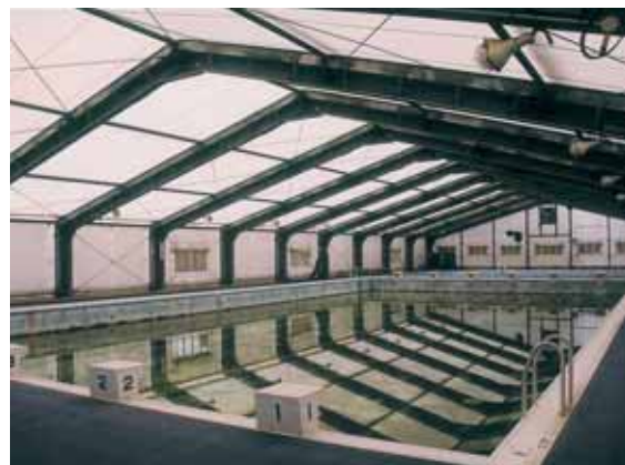
改修が予定されているB&Gプール
