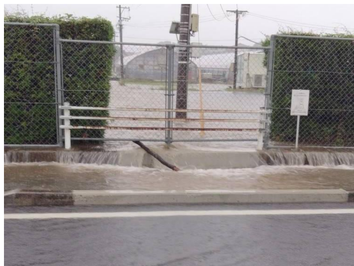
井田川溢水状況11:20頃
