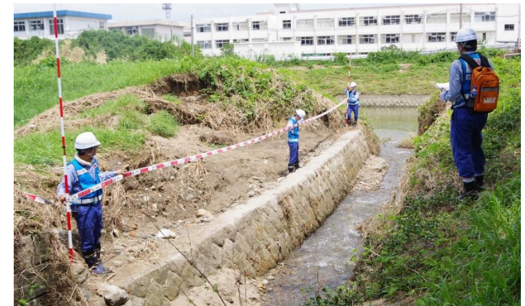
河川被害を現況調査
