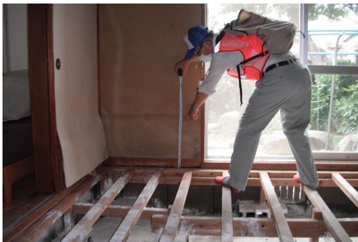
職員が床上浸水の高さを確認
