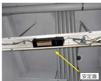
蛍光灯内の安定器
