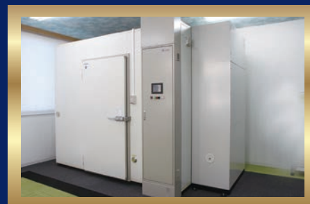
田中さんがシステム設計、製造管理を行った恒温恒湿室
