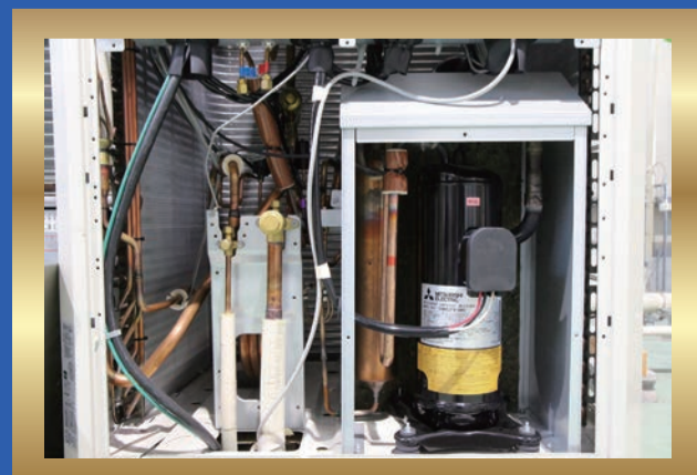
冷凍機の圧縮機
