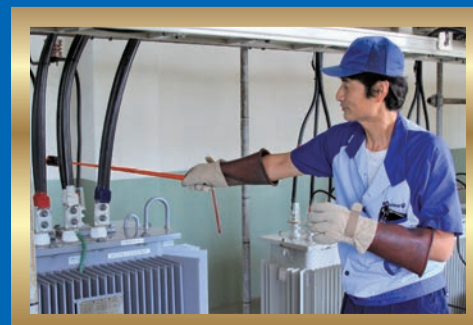
高圧機器の点検作業
