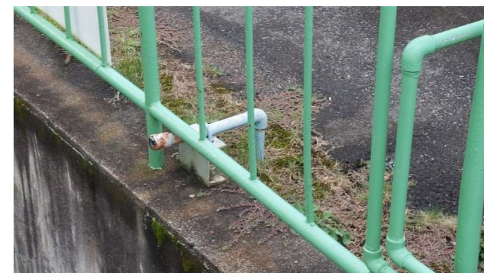
水栓（既存管利用）
