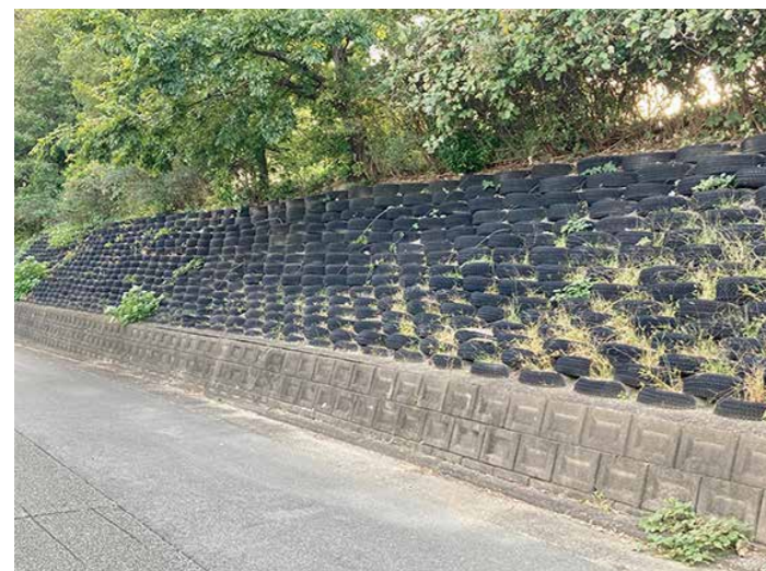
石垣ならぬ「タイヤ垣」(旭町)。旧三ノ丸付近
