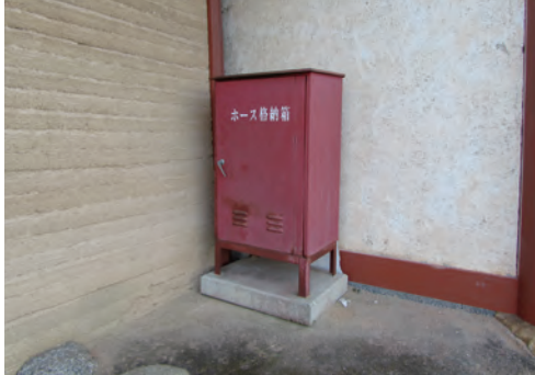
図 9-2-6 消防設備 (肥前国庁跡/佐賀市)
