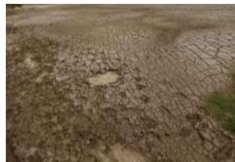
大雨による敷地への土砂の流入
