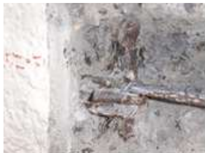
コンクリートの劣化
