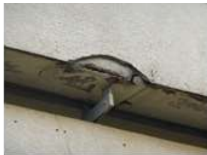
モルタルの剥落
