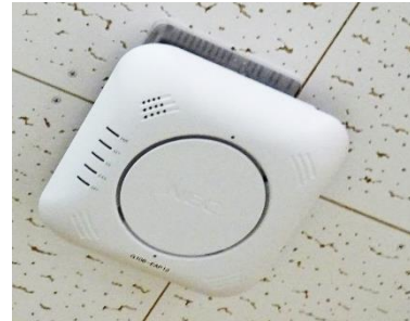
教室の天井に設置されたアクセスポイント
