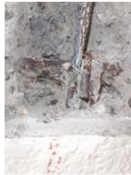
コンクリートの劣化
