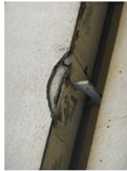
モルタルの剥落
