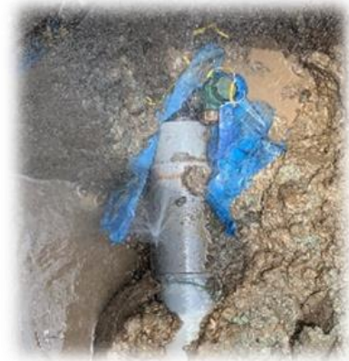
ビニル製配水管の漏水状況
