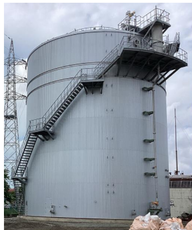
鋼板製消化槽（本体完成写真）
