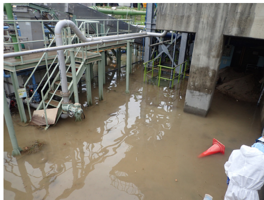
▲ 平成30年度 西日本豪雨被災状況 (中央浄化センター)
