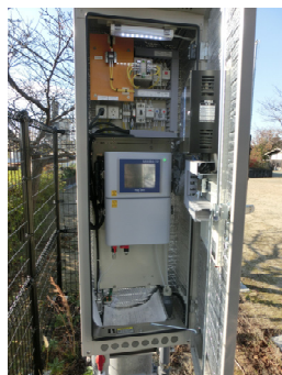
▲ 遠隔監視装置による残留塩素の測定 (城島町西青木の残留塩素モニター)
