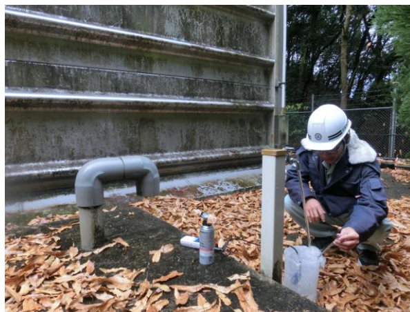
高良内配水池
