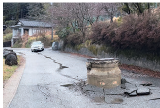
令和6年能登半島地震にて隆起したマンホール
