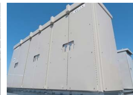
リチウムイオン蓄電池
