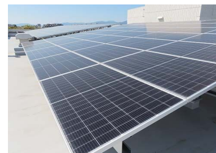
屋上の太陽光パネル
