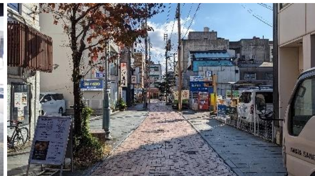
■老朽化し凹凸のある路面
