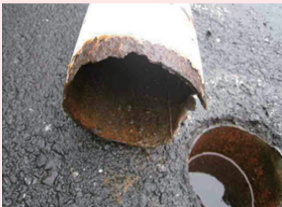
ポールの根腐れによる倒壊
