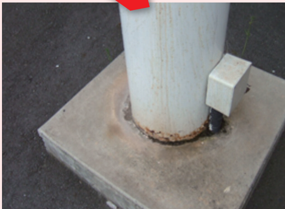
ポールの根元にサビが発生
