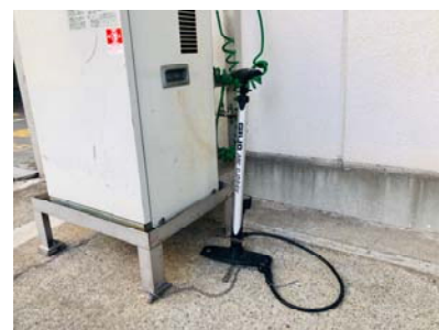
図 25 事業所に空気入れを設置した例
