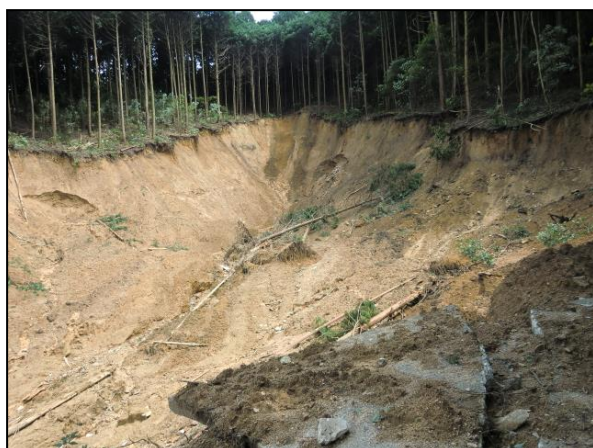
平成 24 年 7 月九州北部豪雨による急傾斜地の崩壊状況
