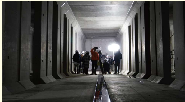
コンクリート柱を252本並べてできた地下空間を報道機関に公開
