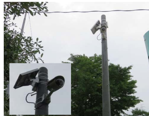
簡易監視カメラ設置(例)
