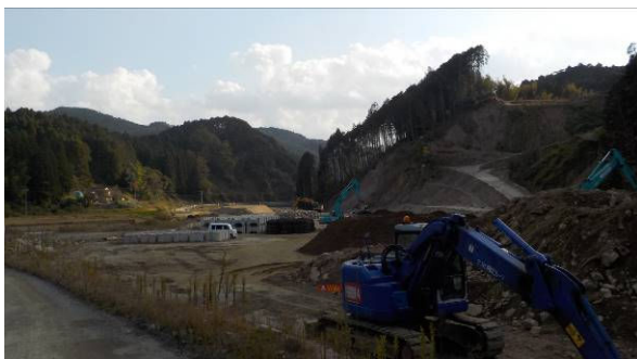
●杷木松末地区の被災状況
