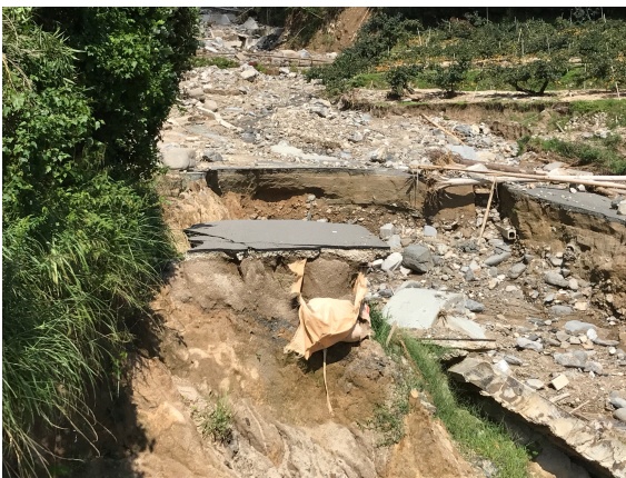
●土砂により市道が完全に流された状況
