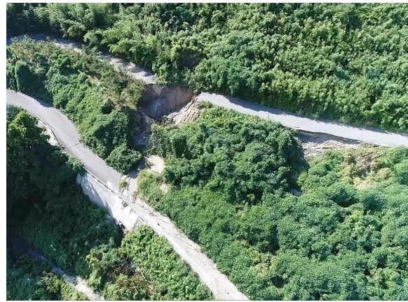
●山間部の市道が崩落した状況
