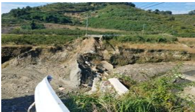
●堤体が決壊しているため池（ため池右側）
