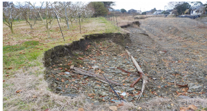
●大雨により柿畑が流失している様子
