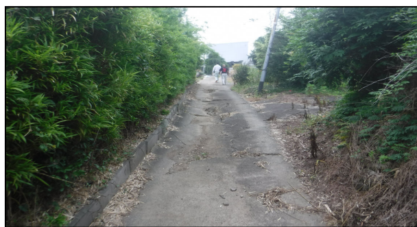
○路面沈下により被災した道路の状態
