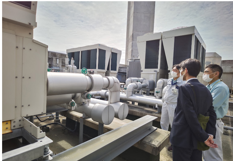
施設の屋上にあるチラー設備を見学させていただきました
