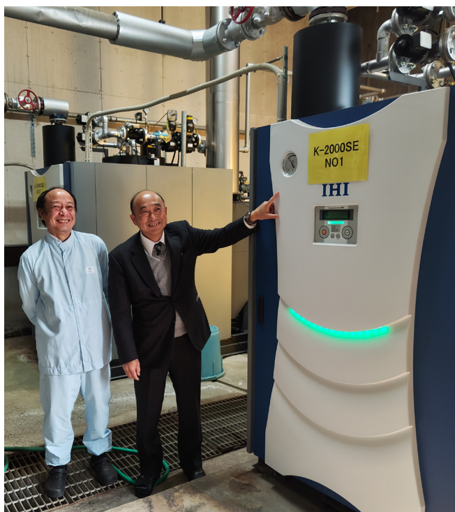
2022年に設置した天然ガスボイラー
